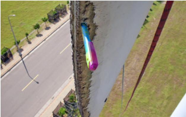
Erosionsschäden an der Vorderkante eines Rotorblatts breiten sich meist schnell aus, wenn der Materialverlust erst einmal begonnen hat. Der Servicetechniker hat ein Loch mit einem Kugelschreiber markiert. © Seilpartner Windkraft GmbH
